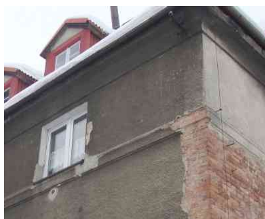
Fot.6 Fragment gzymsu międzykondygnacyjnego oraz koronującego.
