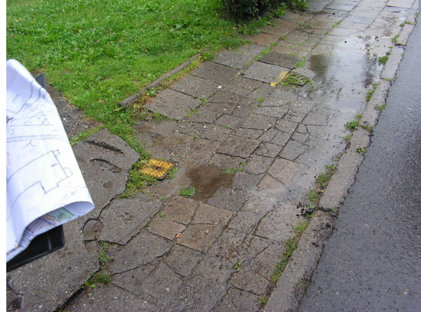
Zdj. nr 4 Uszkodzenia nawierzchni chodników
