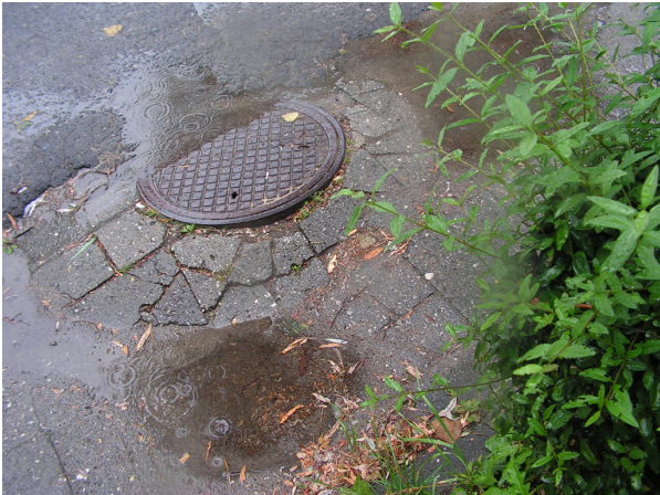
Zdj. nr 3 Zapadliska chodników w rejonie studni kanalizacyjnych
