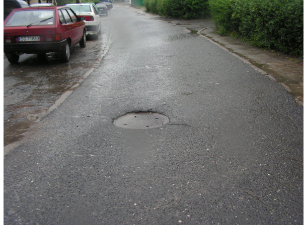
Zdj. nr 2 Zapadnięte klapy studni kanalizacyjnych
